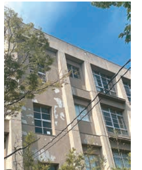
壁が剥がれ落ちているところがいくつもあり、応急処置でしのいでいます▶
